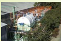
排水処理設備
