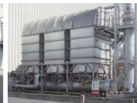
蓄熱脱臭設備
