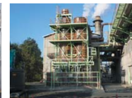
排ガス洗浄設備
