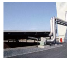
土壌脱臭設備
