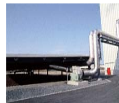
土壌脱臭設備
