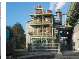
排ガス洗浄設備
