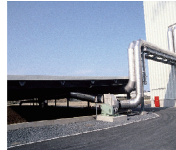
土壌脱臭設備
