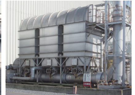
蓄熱脱臭設備
